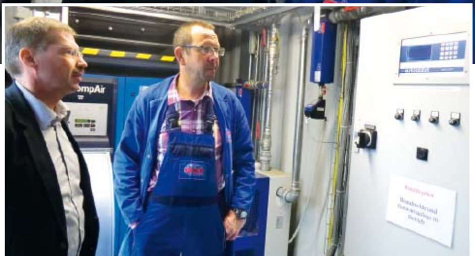
■ Abb. 4: Norman Kloss (links) und Thoma Schnitzler (rechts) in der Druckluftstation, vor dem Airleader. Das System verbindet leistungsfähige Verdichter und Druckluft-Aufbereitungskomponenten unterschiedlichster Hersteller zu einem effektiven Gesamtsystem.
