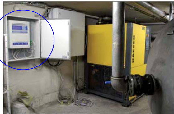
Abb. 36: Druckluftanlagen Wopfinger Baustoffindustrie GmbH
